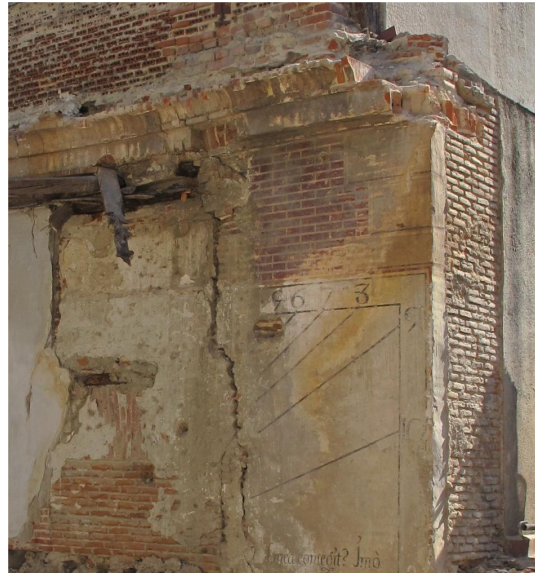
Imagen 3: aspecto del Reloj de sol tras derruirse el edificio que lo tapaba. Se observa la pared oriental de la capilla.
