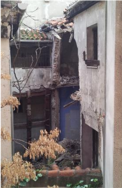
Imagen 1: Aspecto que presentaba el edificio que se derrumbó sobre el patio del Instituto.
